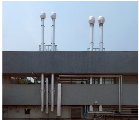
Chimeneas de las Máquinas de Emergencia.
